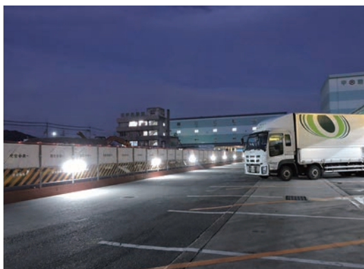
工事現場の照明に
